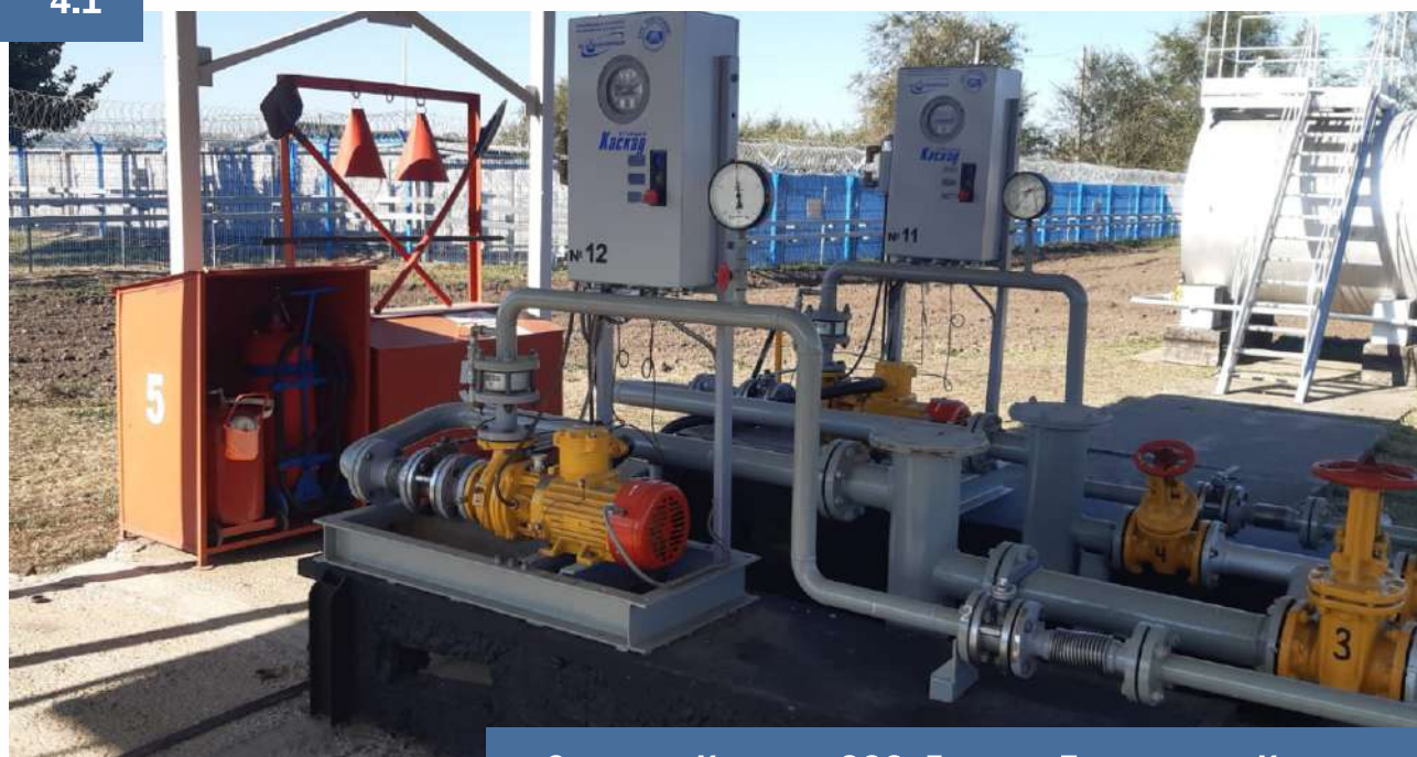
Станции «Каскад», ООО «Газпром Трансгаз», г. Краснодар
